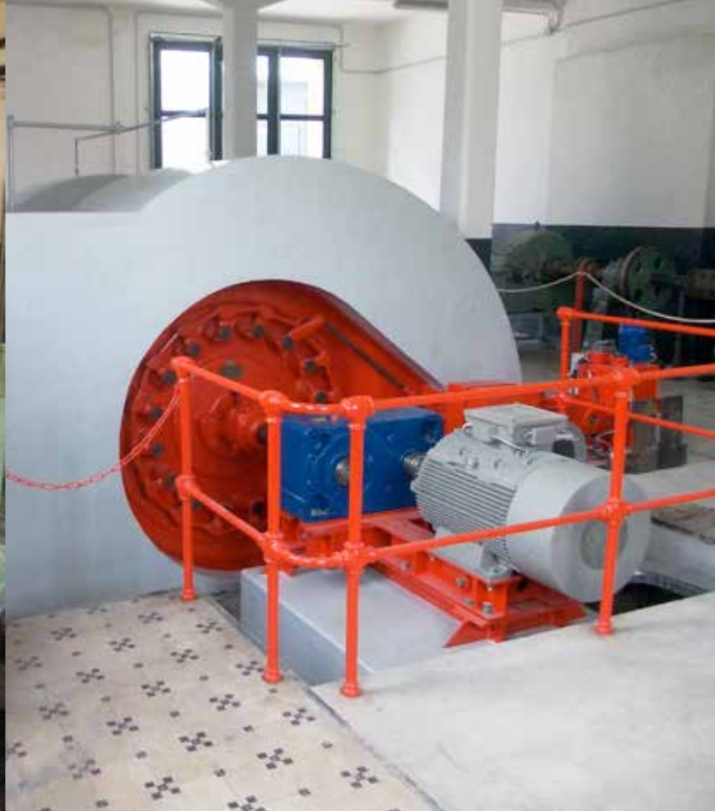
Revamping doppia Francis ad asse orizzontale
